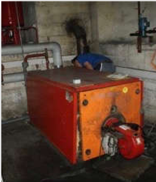
Quelle: Kurs der Kantone Luzern/Aargau „Heizungs-Check“
